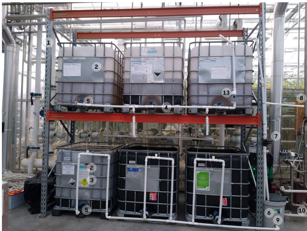
Figur 4 Systemet i sin helhet. På bilden syns bland annat svanhalsrören och nivågivaren som reglerar om det renade vattnet leds till råvattentanken eller tillbaka till returvattentankarna.
